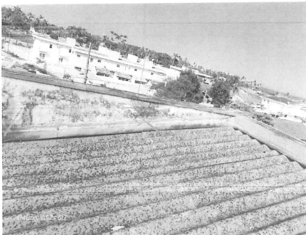
Figura 15 – Platibanda com marcas de umidade e fissura.
