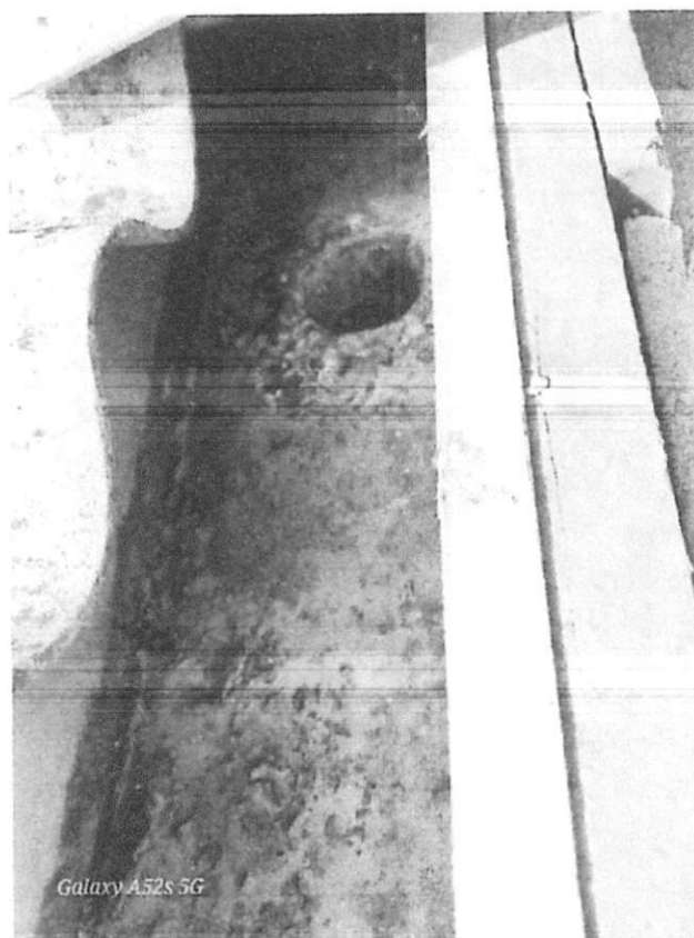
Figura 11 – Acumulo de material junto ao tubo de saída por falta de caimento.
