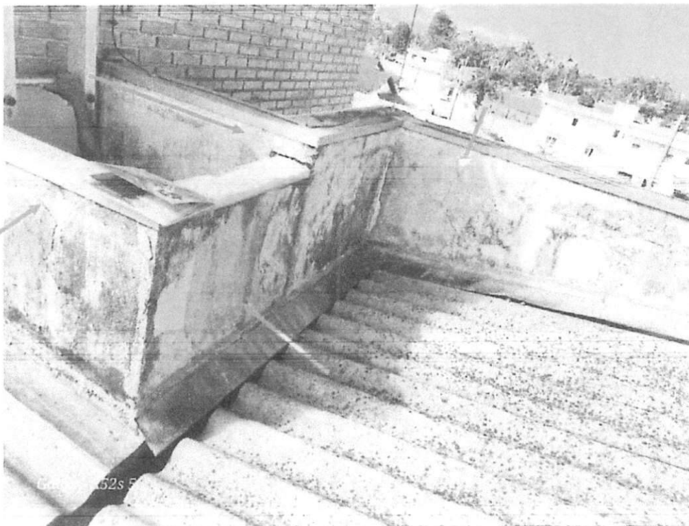
Figura 14 – Rufo descolando e fissuras na alvenaria da platibanda.
