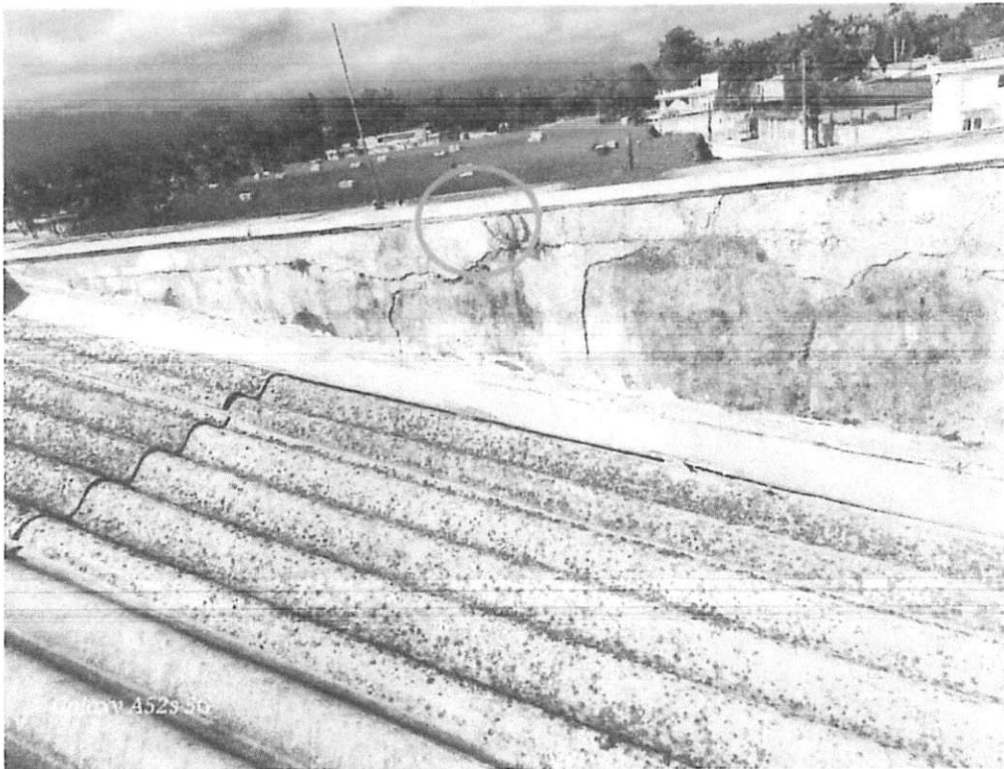
Figura 13 – Vegetação se alocando nas fissuras, indicando umidade e processo avançado de degradação da alvenaria da platibanda.
