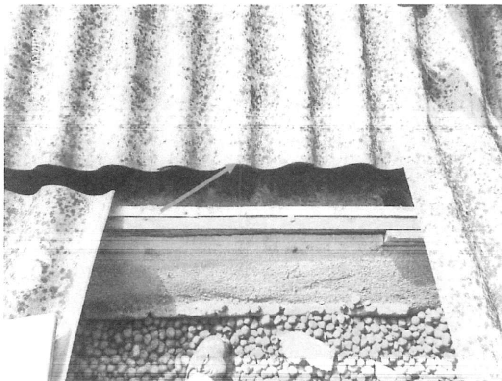
Figura 8 – Dilatação da alvenaria de suporte da calha.
